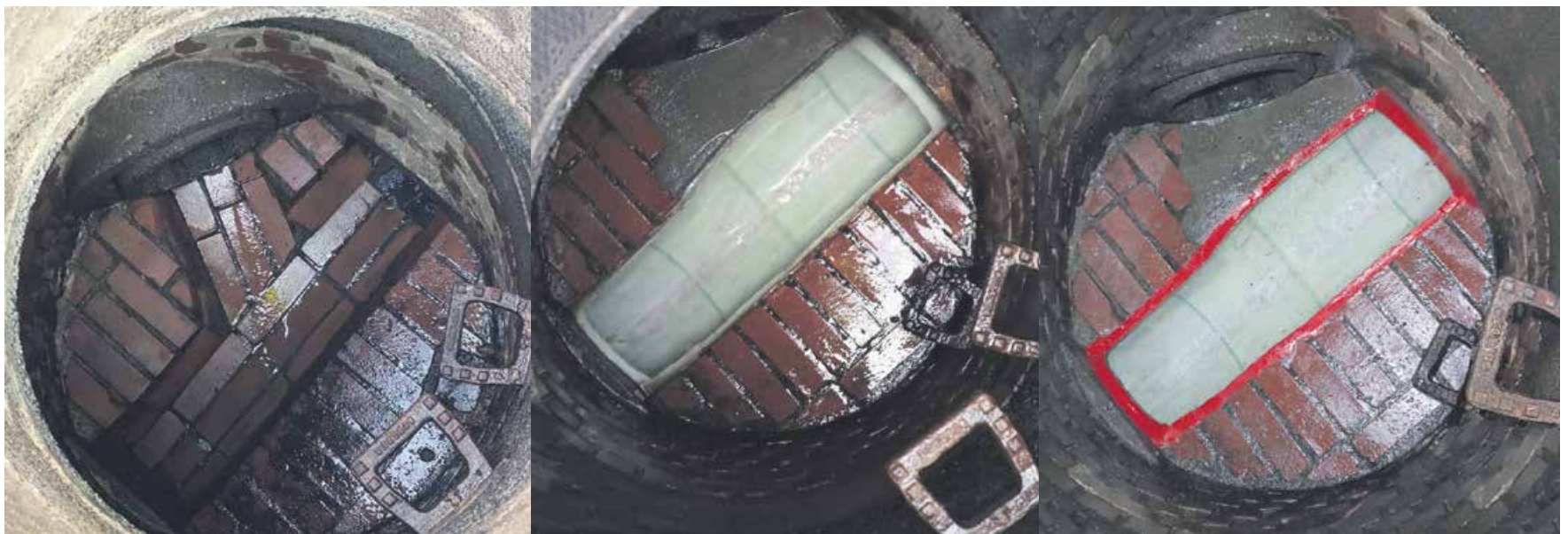
Das sanierungsbedürftige Gerinne.
