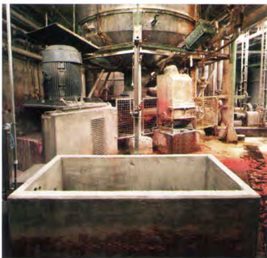
Bild 1: Ausgangslage: Auflage für die Altpapieraufbereitungsaufgabe: Grundwassersammler muss tagwasserdicht abgedeckt werden
