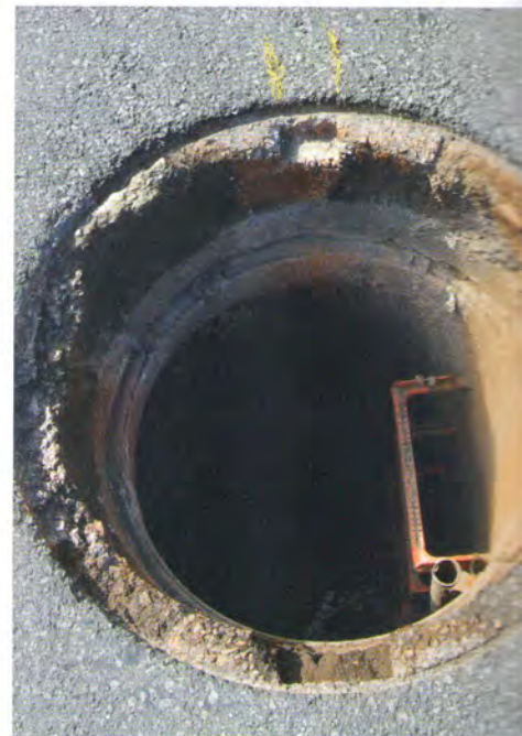
Der Untergrund ist durch die Verkehrsbelastung angegriffen.
