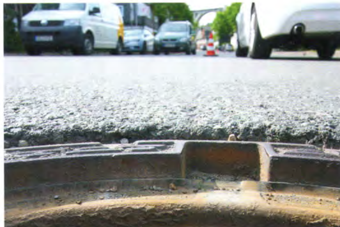
Holperfalle: Deutlich abgesackt ist diese schwimmende Schachtabdeckung.
