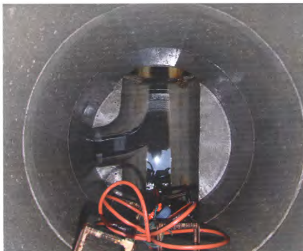
Bild 1: Ausgangslage: kein Liner-Überstand für Anbindung vorhanden
