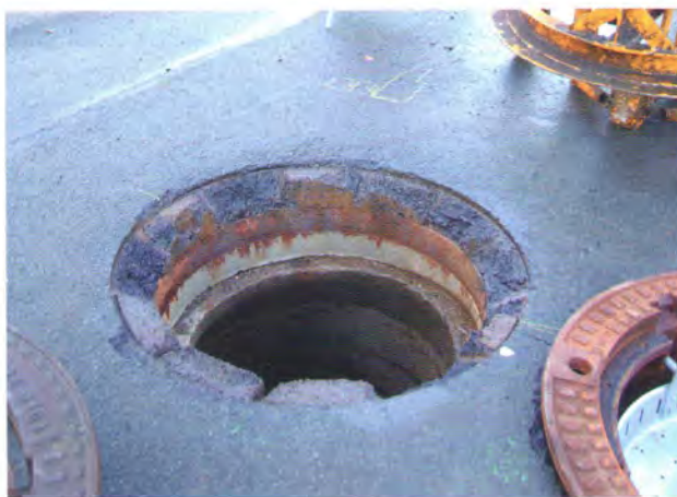
Bild 1: Nach zehn Jahren haben sich die schwimmenden Schachtabdeckungen mit dem Asphalt abgesenkt
