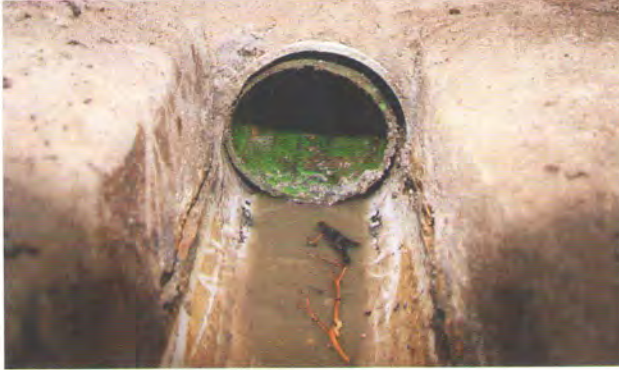
Bild 1: Blickt man in den zu sanierenden Schacht, ist die Fehlauflagestellung des Liners deutlich zu erkennen
