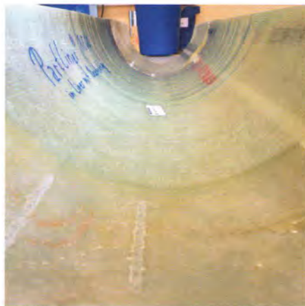
Auf dem Probestück deutlich zu sehen: Die Spülschäden durch die Spüldüse auf dem Liner, die genau dort aufhöhen, wo der Partliner beginnt. | Fotos: resinnovation GmbH
