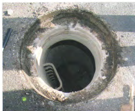
Die Erschütterungen durch den Straßenverkehr haben nicht nur den Mörtel in den Schachtringfugen zerbröseln lassen; der oberste Schachtring war bereits geborsten und musste ersetzt werden.
