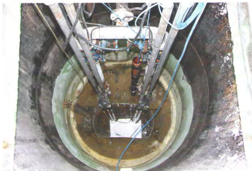
Das Schadensbild: korrodiertes Beton in einem Pumpwerk, in das unter anderem Brauerei-Abwasser fließt. Alle Abbildungen: © resinnovation GmbH
