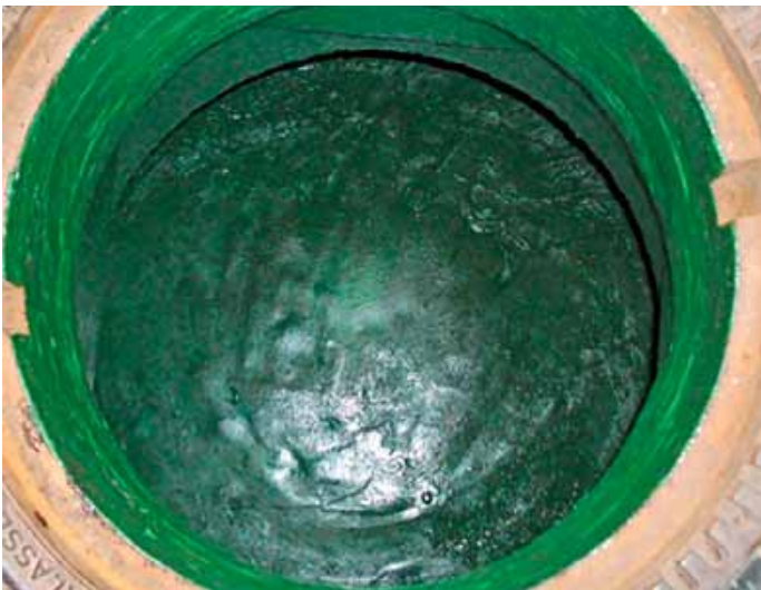
Grüne Antwort auf „grünen“ Treibstoff: Schachtbauwerk mit korrosionsfester resiShield-Beschichtung.
