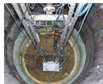
Ausgangsschadensbild: korrodiertes Beton in einem Pumpwerk, in das unter anderem Brauerei-Abwasser fließen.
