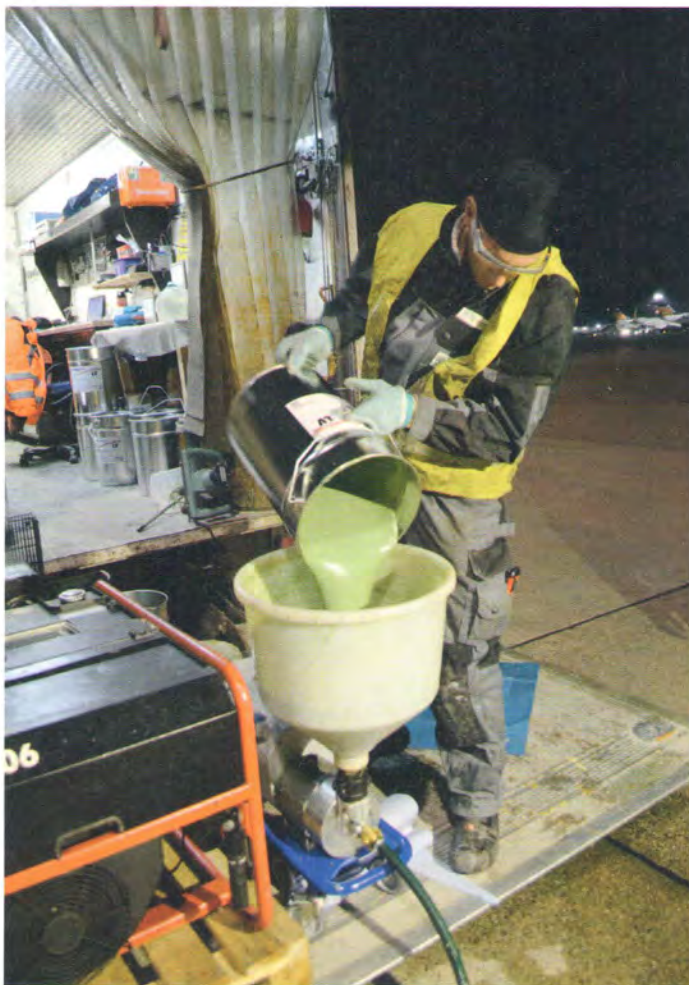
Einfüllen von resiShield LV in die Peristaltikpumpe.
