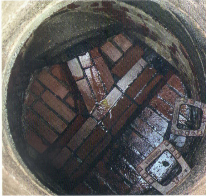
Bild 1: Das sanierungsbedürftige Gerinne
