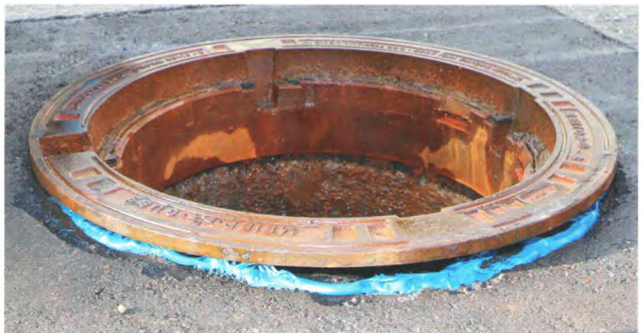
Direkt nach dem Auftrag des Harzes wurde die Schachtabdeckung wieder passgenau eingelegt. | Fotos: resinovation
