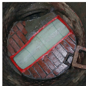
Gerinneliner im gemauerten Schacht: Das neue Verfahren passt sich allen Geometrien und Gegebenheiten an.
